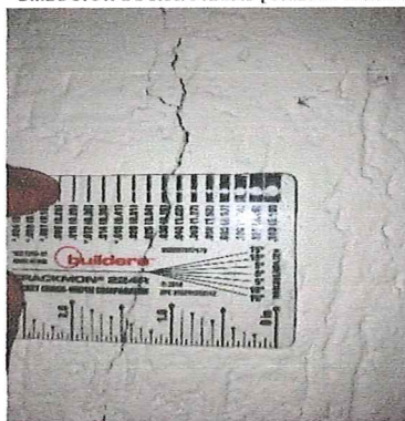
RECTORÍA (GRIETAS EN MUROS DE PLANTA ALTA)
