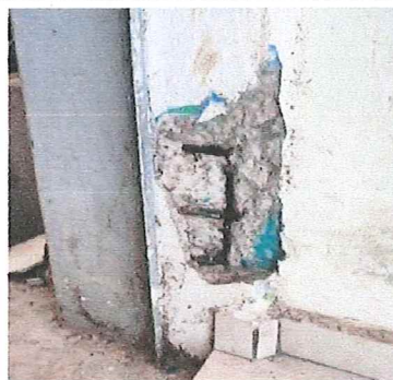
SERVICIOS GENERALES Y DPSO (FALLAS EN ARTICULACIONES PLÁSTICAS DE COLUMNAS EN EL EXTREMO INFERIOR)
