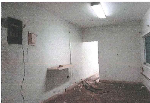
TEATRO UNIVERSITARIO (GRIETAS EN MUROS, SIN EMBARGO, SE ENCUENTRA EN REMODELACIÓN)
