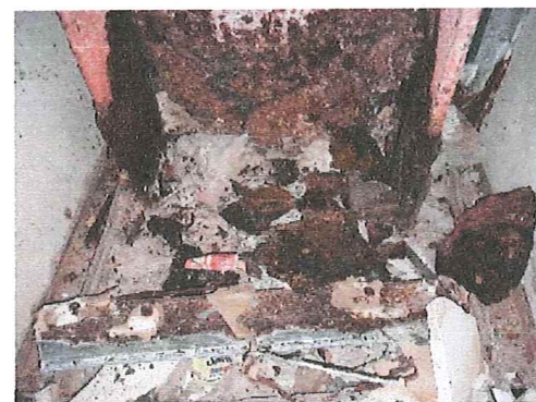
CIVE (CORROSIÓN IMPORTANTE EN CONEXIONES)
