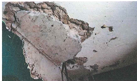
EDIFICIO DE FINANZAS (PERFORACIONES, DESPRENDIMIENTO Y EXPOSICIÓN DE VARILLAS)
