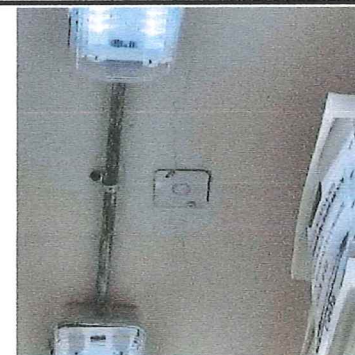
SERVICIOS ESCOLARES (GRIETAS EN LOSA)
