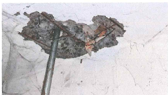
ARCHIVO GENERAL Y CDEUT (DESPRENDIMIENTO DE RECUBRIMIENTO Y EXPOSICIÓN DEL ACERO EN LOSA)
