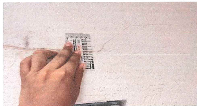
DIRECCIÓN DE EDUCACIÓN A DISTANCIA (GRIETAS DIAGONALES)
