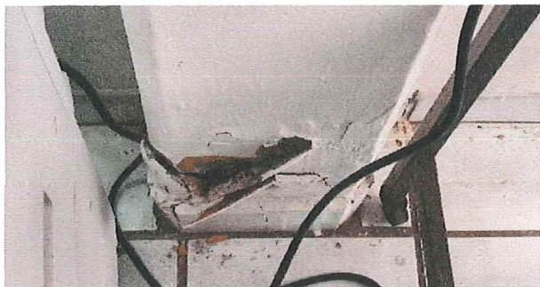
SERVICIOS ADMINISTRATIVOS (FALLAS EN ARTICULACIONES PLÁSTICAS DE COLUMNAS EN EL EXTREMO INFERIOR)
