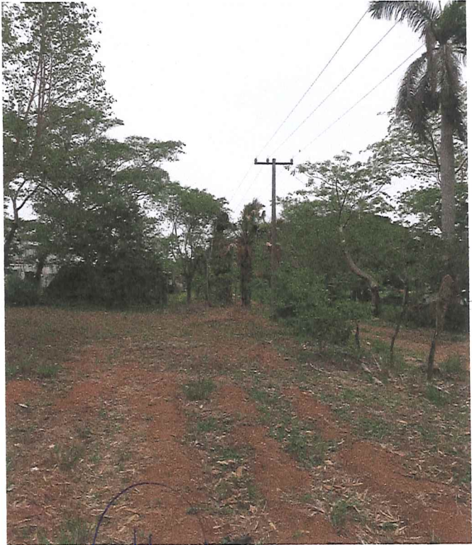
POSTE TRANSICION AEREA-SUBTERRANEA COORDENADAS UTM 504556, 1966237 N
