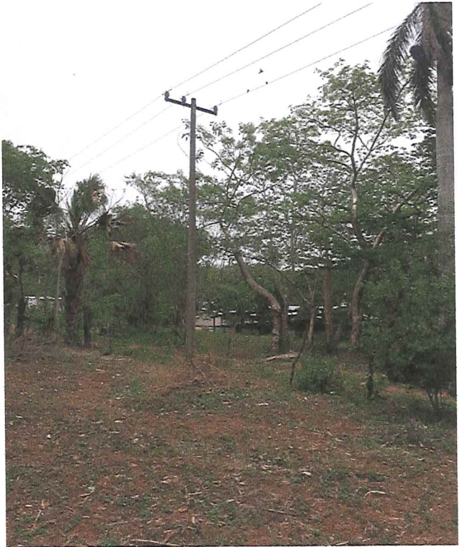
POSTE TRANSICION AEREA-SUBTERRANEA COORDENADAS UTM 504556, 1966237 N
